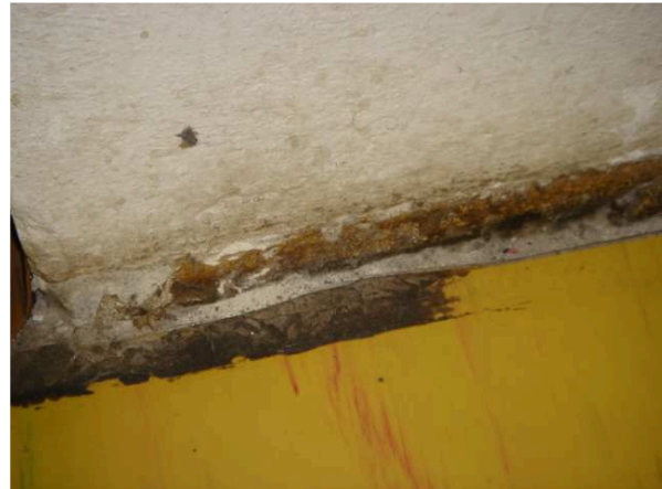
Obrázek 5: foto - projev plísně na vnitřní straně obvodové konstrukce, které je způsobeno v důsledku poškození hydroizolační vrstvy spodní stavby nerovnoměrným sedáním
