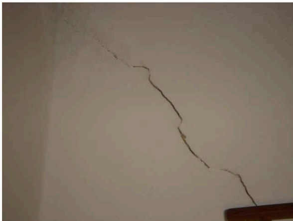
Obrázek 6: foto - projevy trhlin na vnitřní straně obvodové konstrukce, které se projevují v důsledku nerovnoměrného sedání
