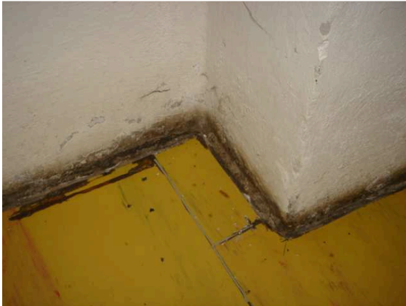
Obrázek 4: foto - projev plísně na vnitřní straně obvodové konstrukce, které je způsobeno v důsledku poškození hydroizolační vrstvy spodní stavby nerovnoměrným sedáním
