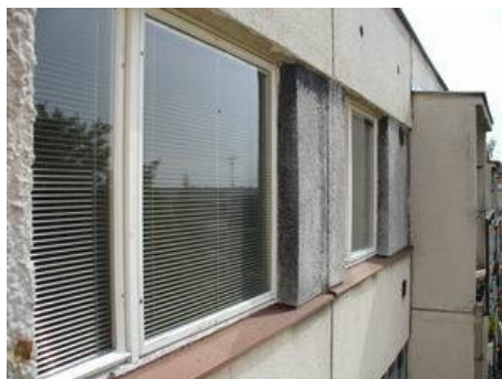
Obr. 4b: Původní stav – umístění okna do ozubu v obvodovém plášti
