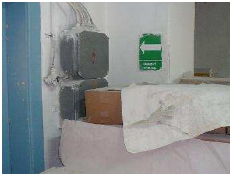
Obr. 6. 2: Nepřístupný hlavní vypínač elektrického proudu na pracovišti [10].
