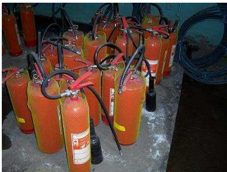
Obr. 6. 5: Nerozmístěné hasicí přístroje, foto D. Petrželka 2008.
