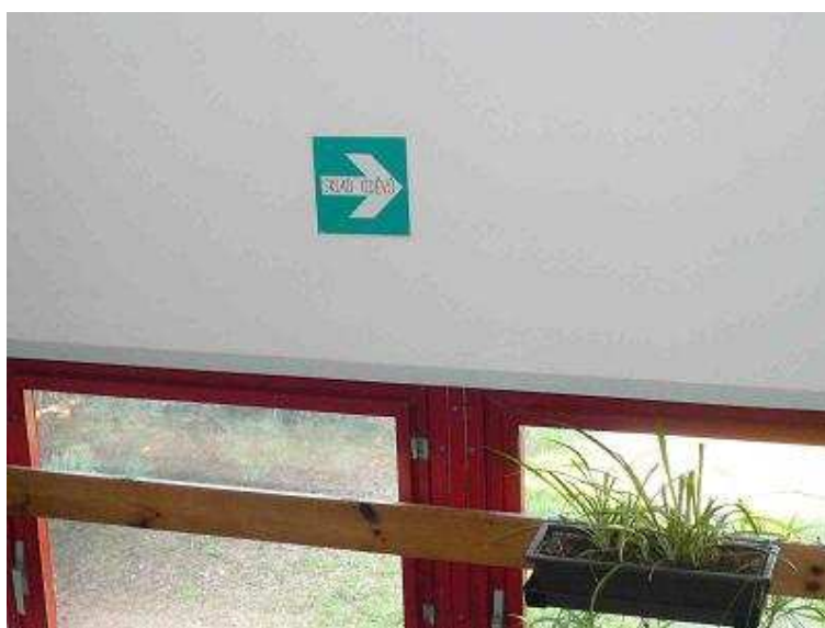
Obr. 6. 4: Zneužití značky informující o směru úniku osob z objektu (otočení proti směru úniku a znehodnocení nápisem sklad oděvů) [10].
