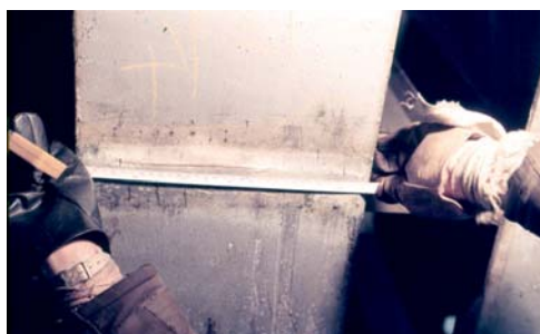
Obr. 11: Zjištěné únavové trhliny nepřípustných délek na dolním pásu.
