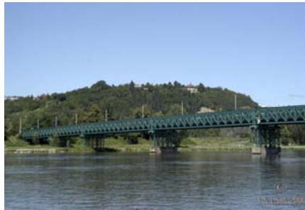
Obr. 13 Současné příhradové mostní provizorium.
