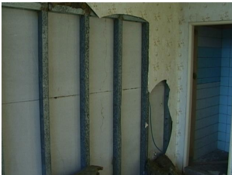
Obr.7: Nosná konstrukce zničených příček
