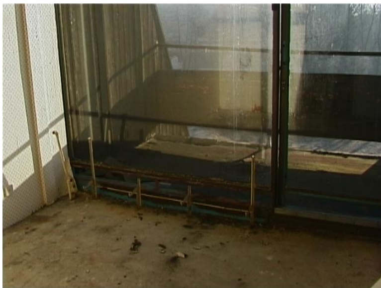
Obr.8: Čelní prosklená stěna pokoje – chybějící radiátory ÚT
