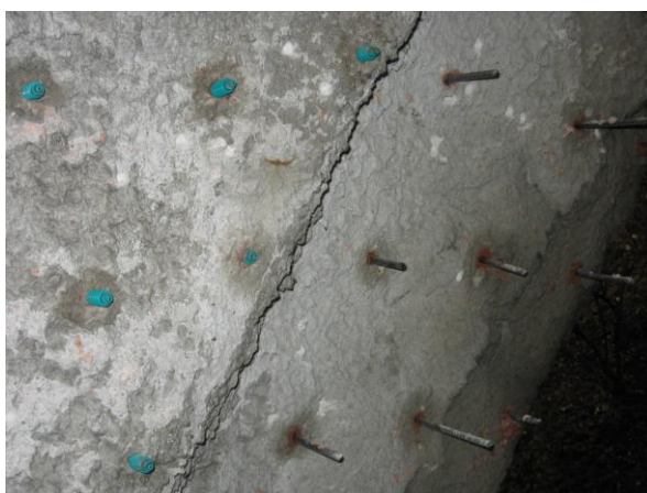
Obr.13: Vlevo pakry pro tlakovou injektáž, vpravo výztuž před nasazením pakrů (vyztužený injektážní vrt.
