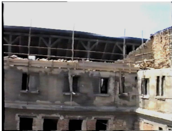
Obr.2: Pravá část zřícené stěny
