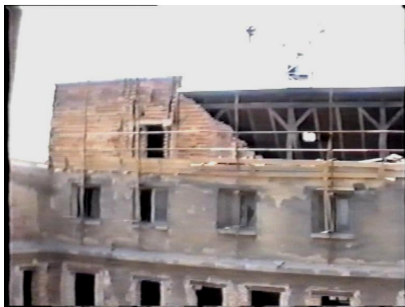
Obr.1: Levá část zřícené stěny
