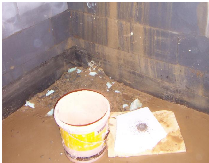
Obr.4 Plynosilikátové vlhké zdivo v suterénu při výstavbě
