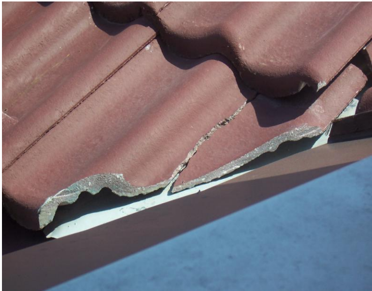
Obr.10 Poruchy objektu na střešní krytině
