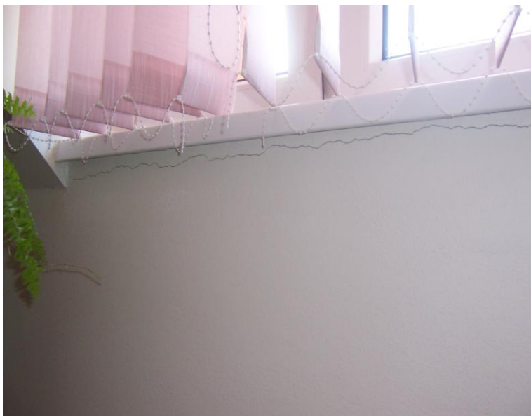
Obr.9 Poruchy objektu u parapetu
