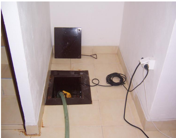
Obr.6 Sběrná čerpací jímka
